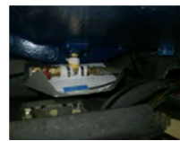
増速機の漏油感知
