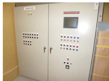
集中動力制御盤
