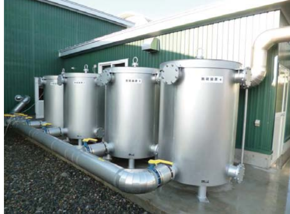
乾式脱硫装置 (酸化鉄による脱硫)
