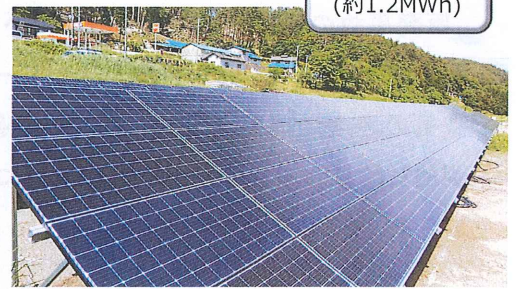
太陽光発電所 (約1.2MWh)
