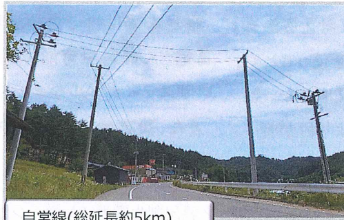
自営線(総延長約5km)
