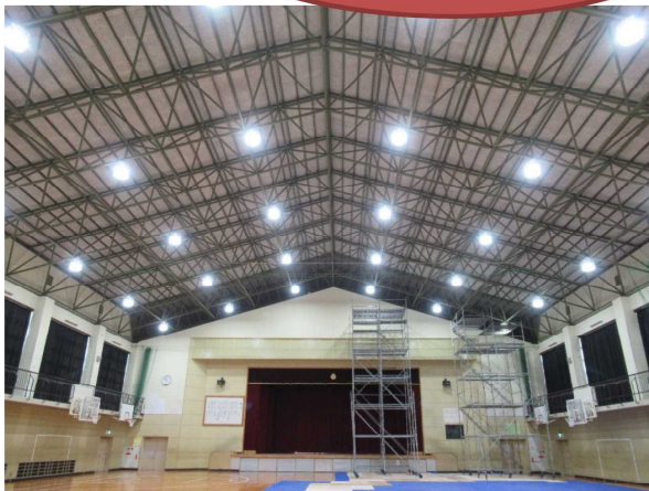
中学校体育館へのLED照明導入
