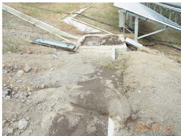
20MW発電所 O&M受託時は管理不備により開水路が 土砂で閉塞し洗堀が発生していた
