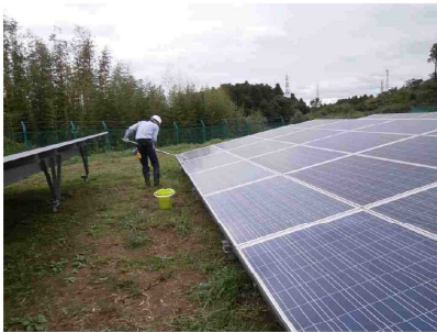
常駐電気主任技術者による モジュール清掃状況
