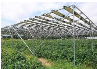
発電設備の外観
