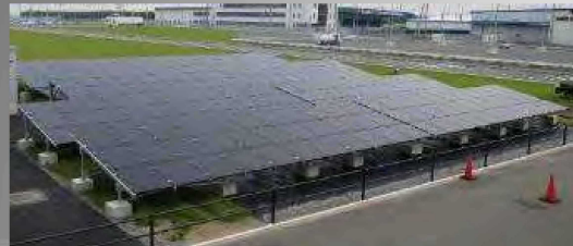
太陽光パネル
