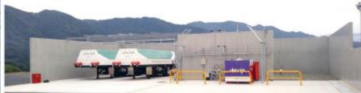
水素出荷設備 19.6MPa 400Nm 3 /h
