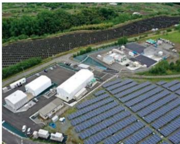
電力貯蔵技術研究サイト全景
