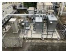
水素ボイラー 250kg/h 純水素燃料電池 5kW
